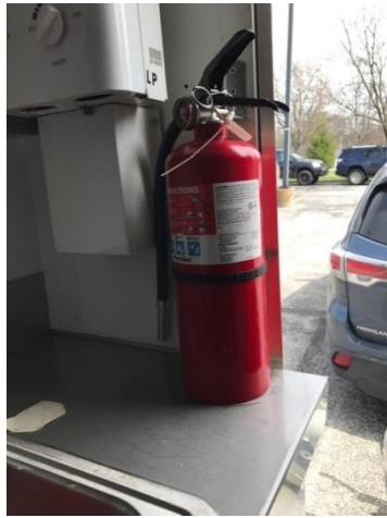
ABC Extinguisher 3A:40BC /1A:BC
